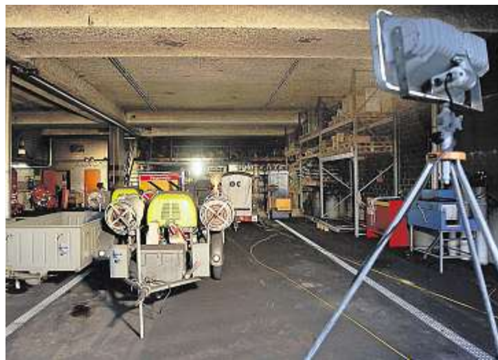
Rauch und Russ haben das Feuerwehrdepot in Buchs verwüstet. Bild: mas
